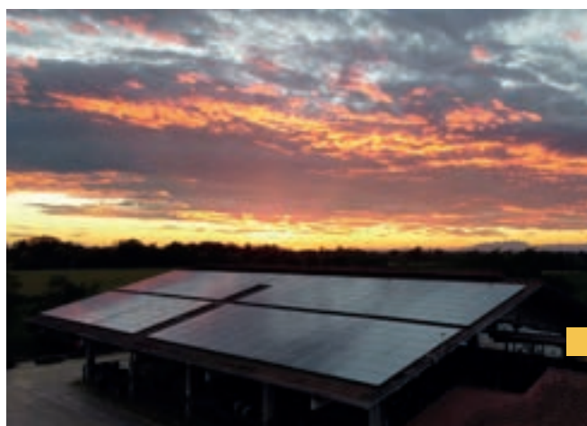
Impianto fotovoltaico sul tetto dell'allevamento.
